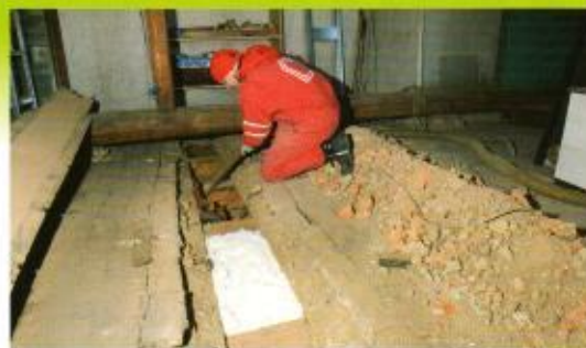
Půdu není třeba kompletně vyklízet, k izolaci postačí jen několik otvorů. Dvě přední pole jsou hotová, pracovník plní dutinu izolací.
