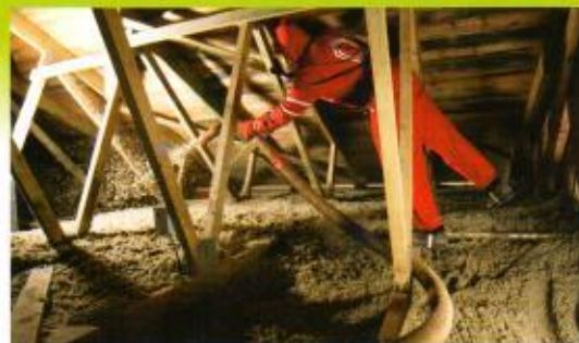
Neúnosný pohled vyžaduje opatření. Provedení finální vrstvy a vyrovnání na požadovanou výšku izolace.
